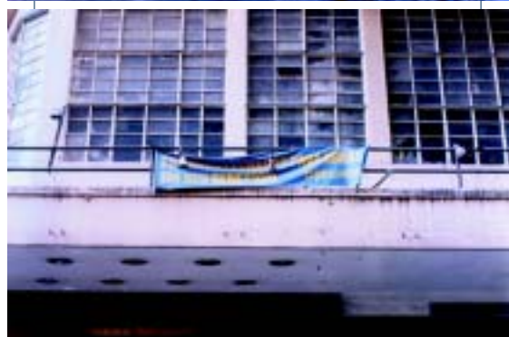
abandono, lixo, animais mortos e destruição ao patrimônio público da cidade do Rio de Janeiro
